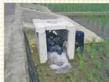
▲県営事業で整備されたパイプライン
