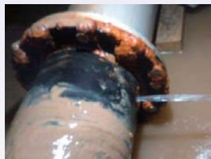
老朽管の漏水状況
