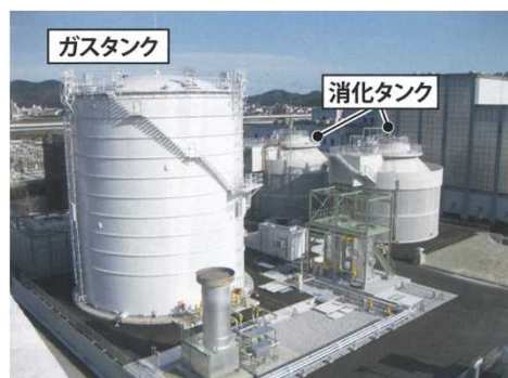
消化タンクとガスタンク (写真提供：高須浄化センター)
