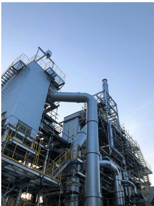
木質バイオマス発電施設 （写真提供：エフビットファームこうち株式会社）
