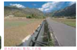
排水路法面に繁茂した状態
