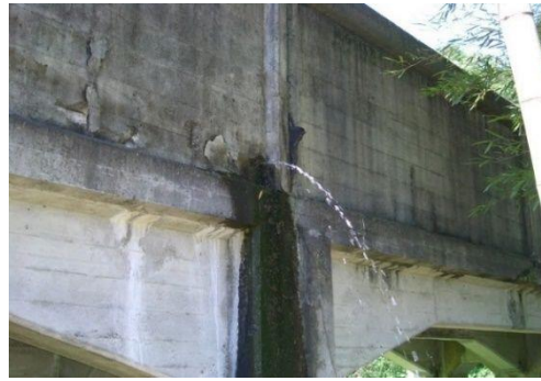
漏水（天川導水路）
