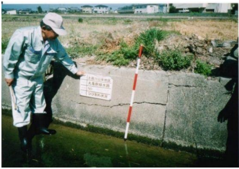
ひび割れ（丸亀幹線水路）
