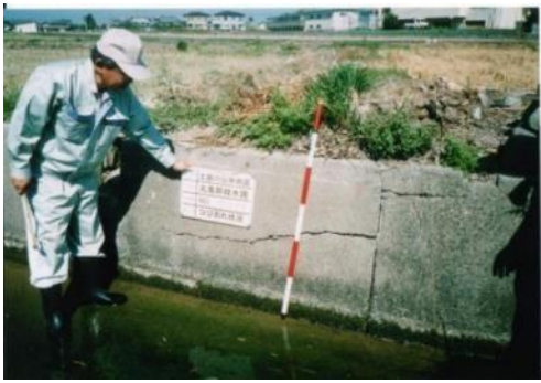
ひび割れ（丸亀幹線水路）
