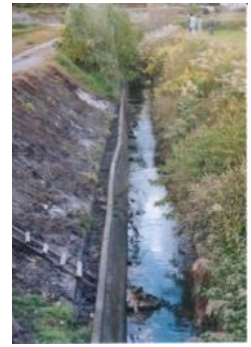
側壁の傾き （仁池導水路）
