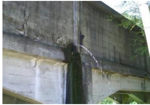
漏水（天川導水路）
