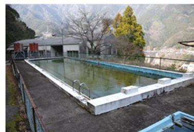
傾いたプール
