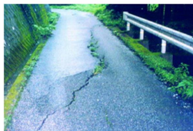
道路の沈下・亀裂
