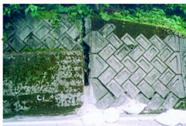
ブロック積擁壁の亀裂
