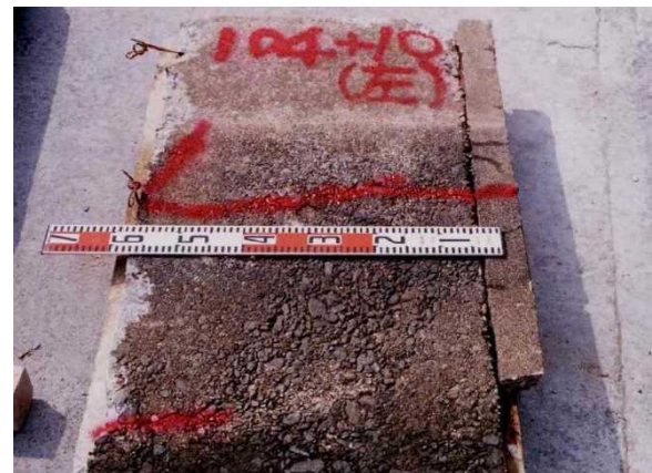
▲水路の摩耗、クラックの状況
