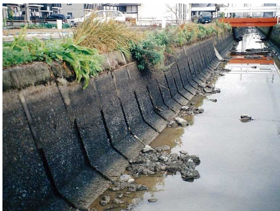
▲改修前の湛井十二ヶ郷用水路（目地剥離、摩耗）
