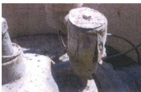
▲電磁弁ボンネット部の錆による 散水不良が発生（彦名工区及び弓浜工区）
