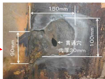
▲腐食状況（内面）
