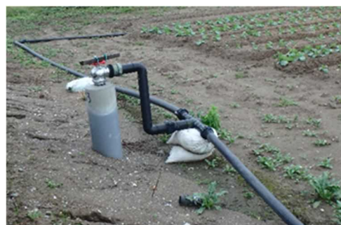
▲ほ場給水栓（揖屋工区）
