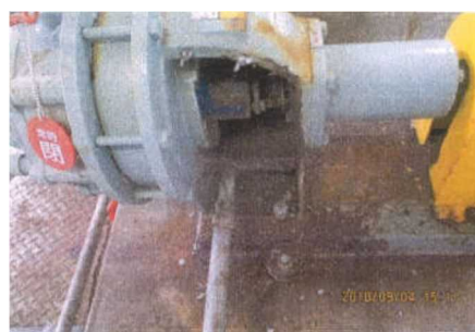
▲弓浜排水機場施設の錆による劣化の進行
