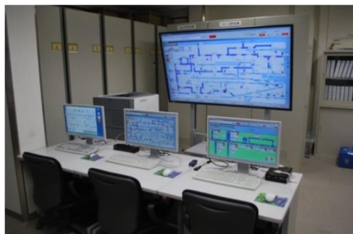
▲水管理システム（中央管理所）
