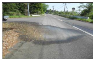
事故の兆候（漏水）
