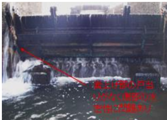
漏水が発生した転倒ゲート（用水路）
