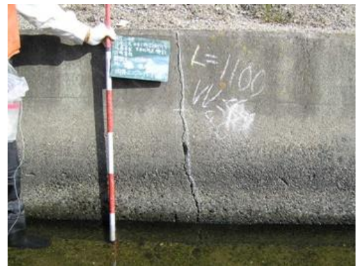
開水路のひび割れ（用水路）
