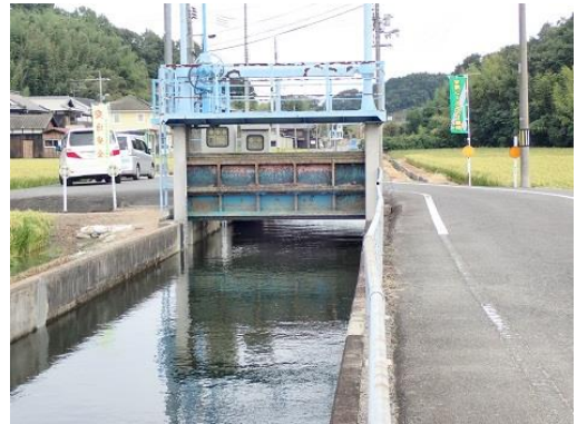
老朽化した制水ゲート（用水路）
