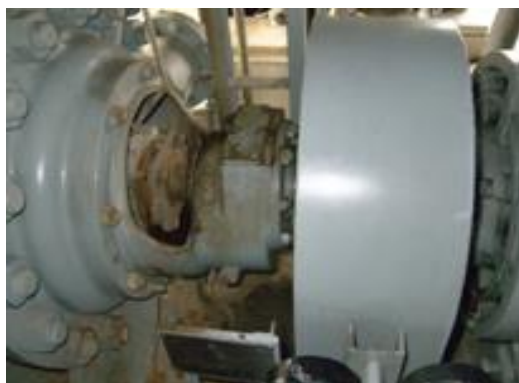
吐出能力の低下（揚水機場）
