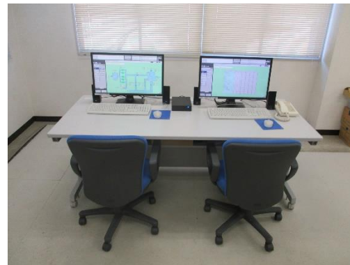
伊方調整池子局（更新後）
