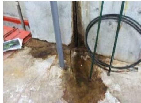
継手部からの漏水 (南予用水取水塔)
