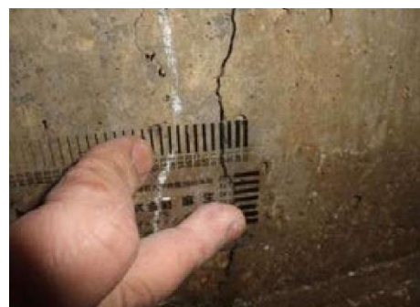
鉄筋コンクリート構造物のひび割れ 開水路(南北分土工)
