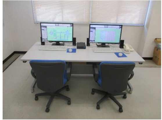
伊方調整池子局（更新後）
