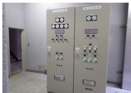
伊方調整池 電気設備（更新後）
