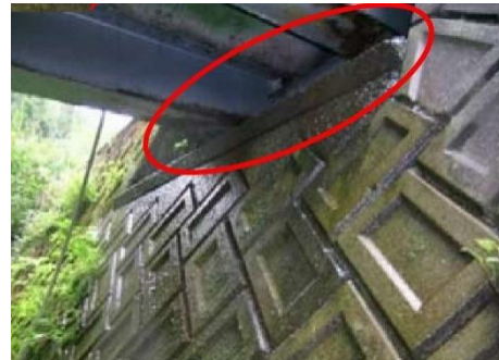
継手部からの漏水 (開水路(水路橋))
