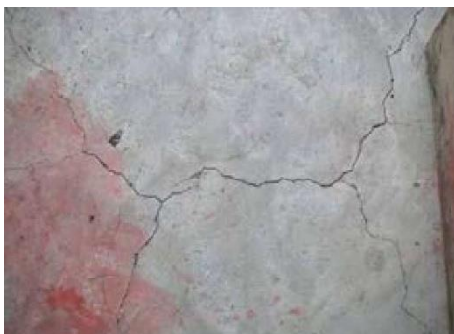
鉄筋コンクリート構造物のひび割れ (南予用水取水塔)
