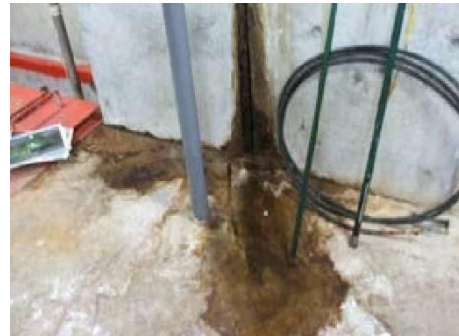
継手部からの漏水 (南予用水取水塔)
