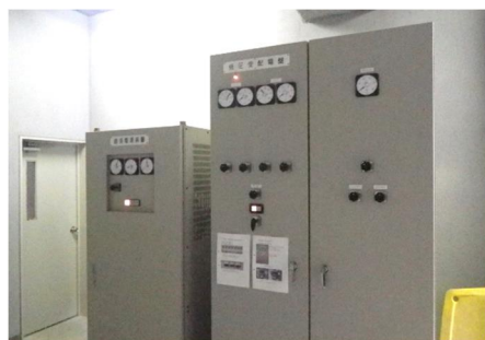
伊方調整池 電気設備（更新前）
