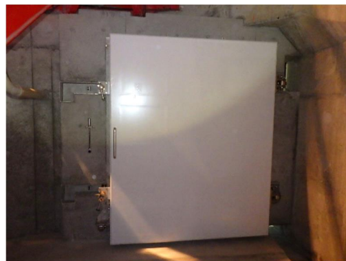
南予用水取水塔 防水扉（整備後）
