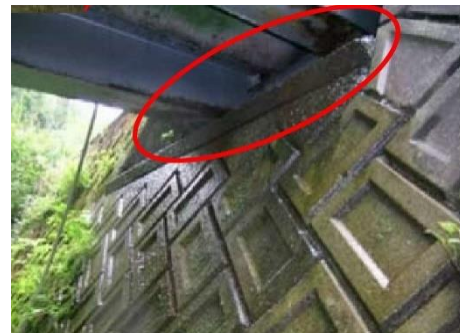
継手部からの漏水 (開水路(水路橋))
