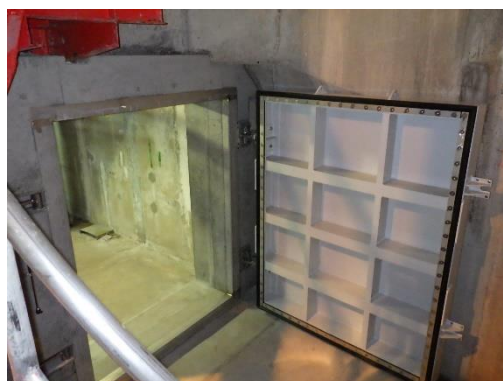
南予用水取水塔 防水扉（整備後）
