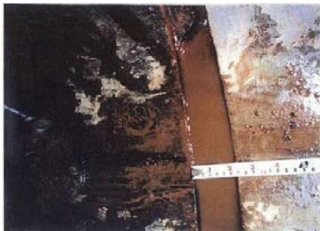
継手部の劣化による抜け出し (今後、漏水が懸念)
