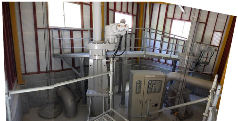
放流設備建屋内 (更新後)
