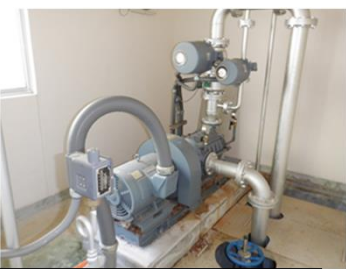
県営幹線水路(ポンプ)
