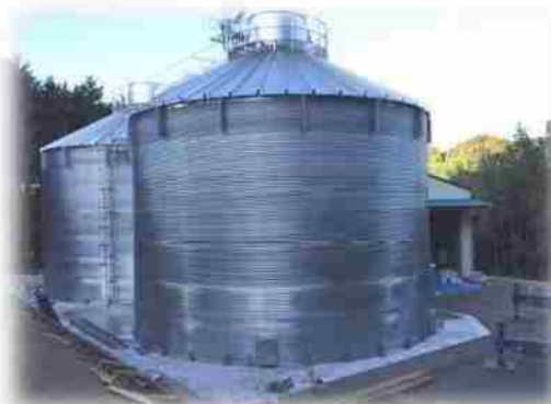
平成28年に完成した飼料用米保管タンク350t×2基
