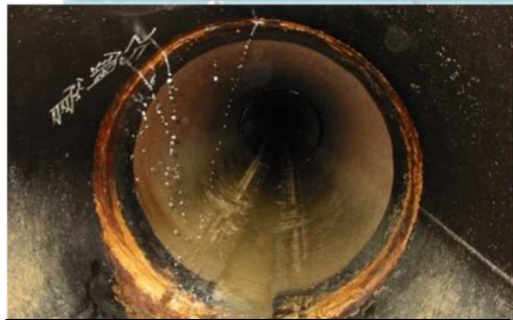
管水路の継目からの漏水状況
