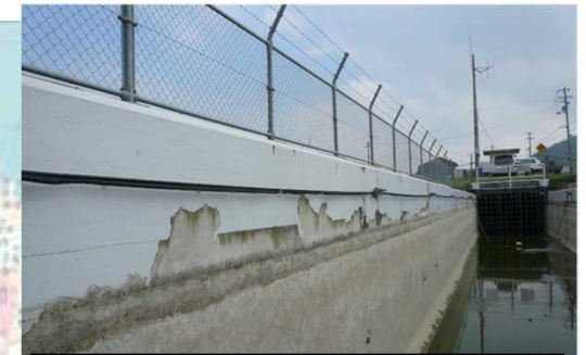
開水路 表面被覆劣化状況
