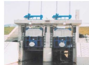
排水機場による湛水解消
