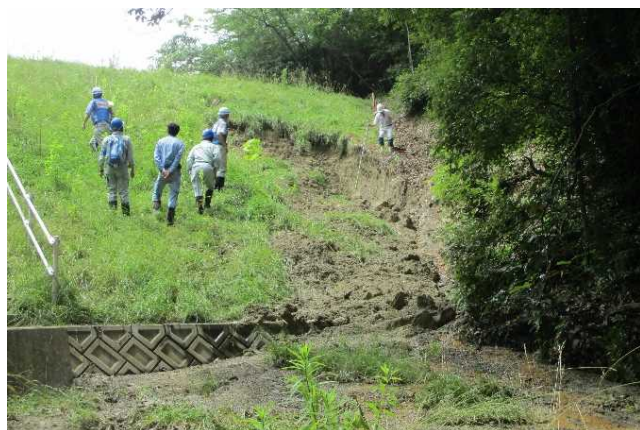
ため池堤体の被災状況確認
