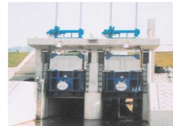
排水機場による湛水解消
