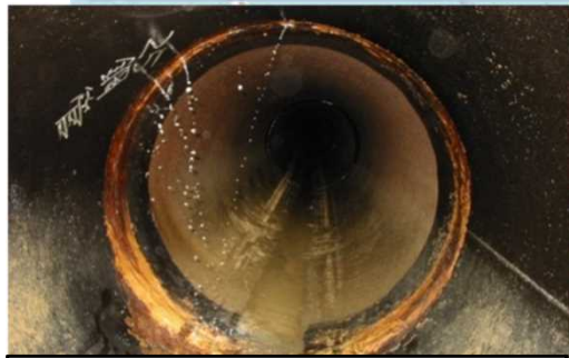
管水路の継目からの漏水状況
