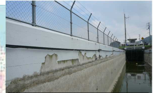
開水路 表面被覆劣化状況
