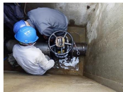
狭小な弁室内での弁類の設置状況
