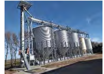
簡易貯蔵タンク
