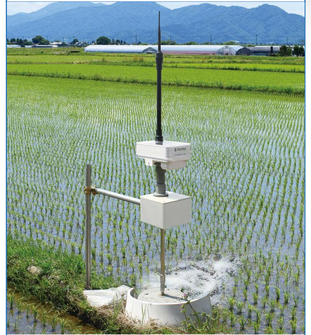
給水バルブ(パイプライン) 自動で給水・止水。
