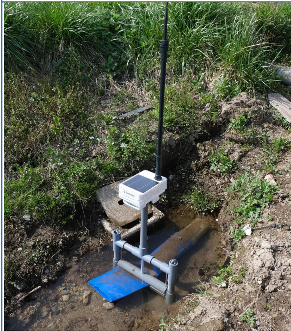
給水ゲート(開水路) 自動で給水・止水。
