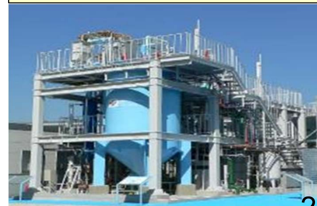
リン回収施設
