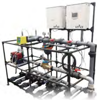
環境制御装置
