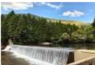
既存の砂防堰（芳井堰）
