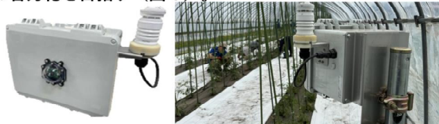
図4 ハウスに設置している環境センサー付きカメラの様子
