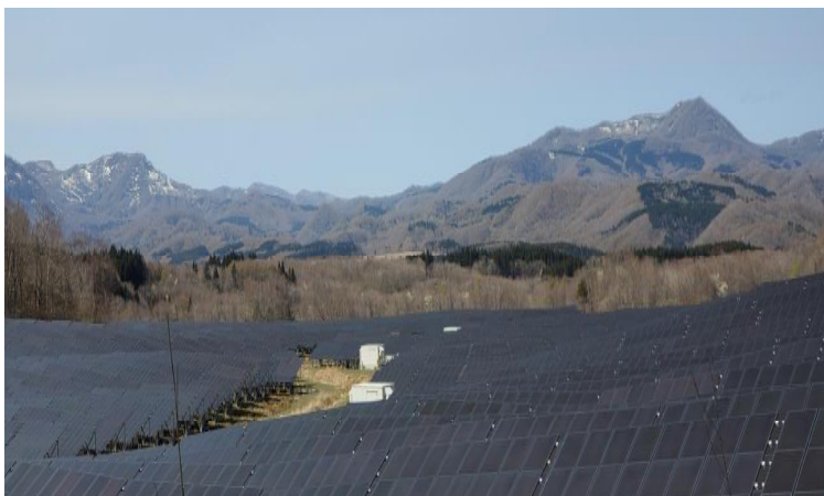
知内町(知内メガソーラー20M発電所)
