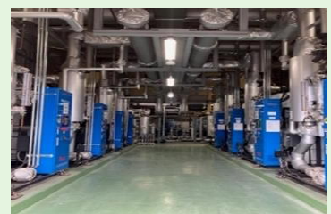
蒸気用ボイラー
