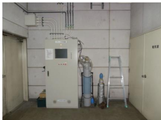
エチレン濃度制御装置
