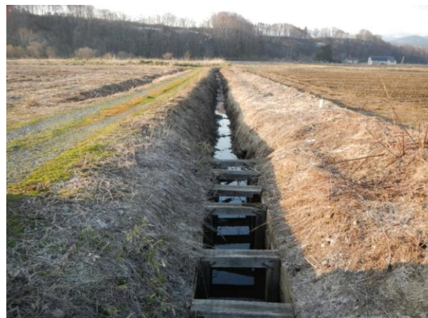
未整備な排水路 (土水路のため崩壊し排水に支障) (北地区)
