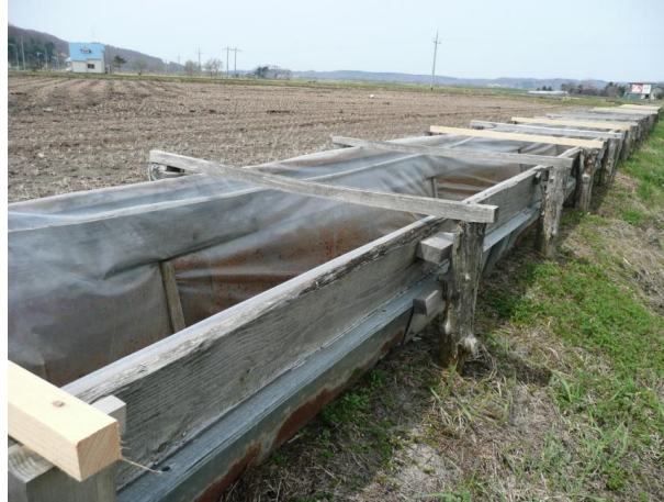
老朽化した支線用水路 (維持管理で補修、かさ上げた用水路) (南地区)
