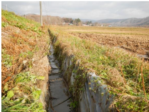
老朽化した末端用水路 (ビニールシートにより応急補修) (北地区)
