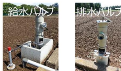
自動・遠隔水管理システム
