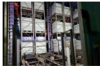
パレット自動倉庫導入により入出庫管理を自動化
