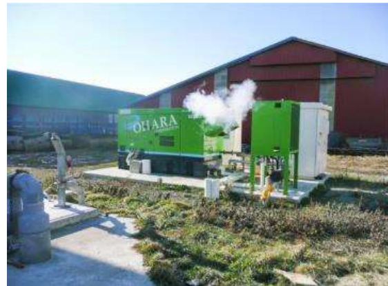
写真4 バイオガスプラントの発電機
