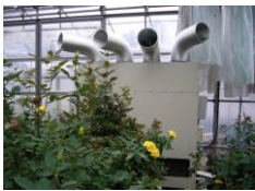
施設園芸用ヒートポンプ
