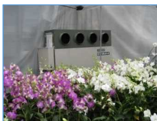
安定的採熱と ヒートポンプ利活用
