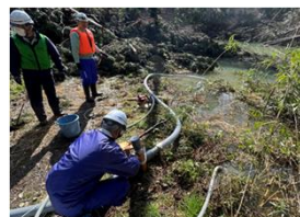
被災ため池の調査
