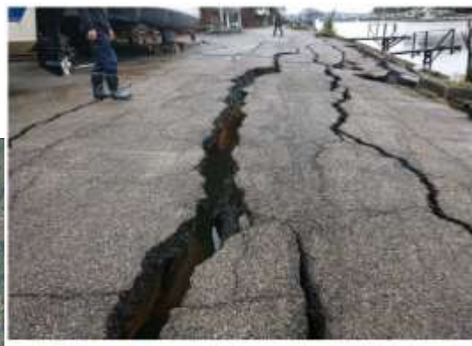
①天端道路ひび(住吉地区)
