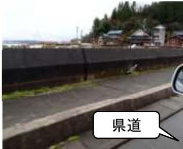
②堤防傾斜
