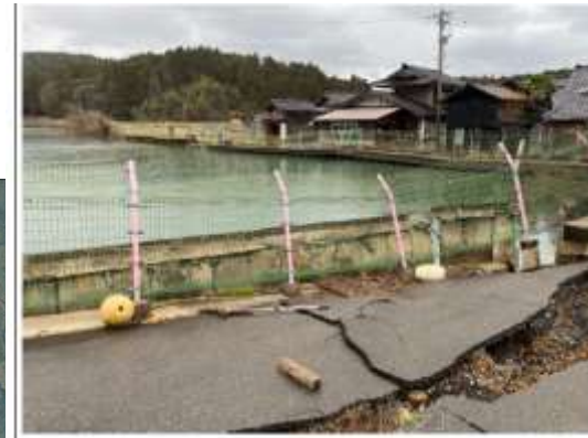
②護岸倒伏(甲地区)
