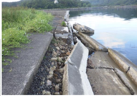
①堤防倒伏(住吉地区)
