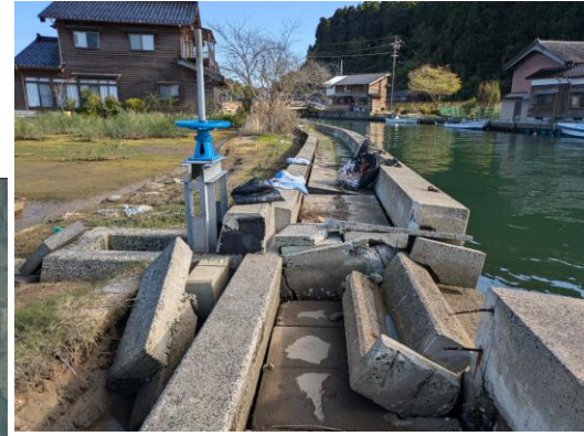
②護岸傾斜(甲地区)
