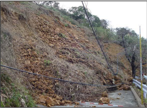
道路法面崩壊
