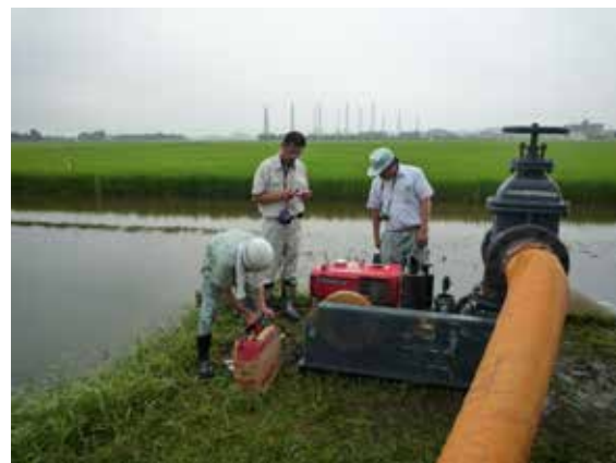
木場潟付近農地でのポンプ設置
