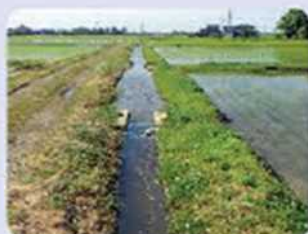
老朽化した用排兼用水路
