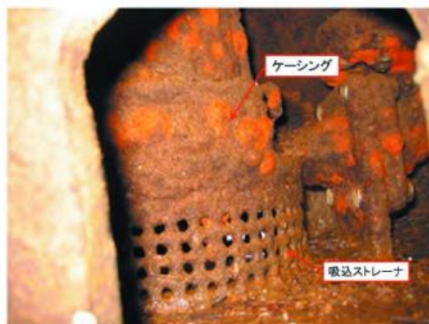
水田揚水機場 (ポンプの腐食)
