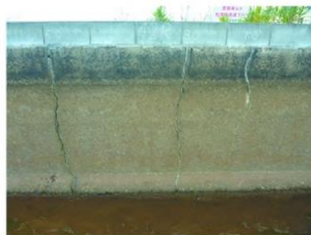
車場幹線用水路 (コンクリートのひび割れ)
