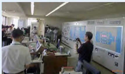
【大秋排水機場 操作室】
