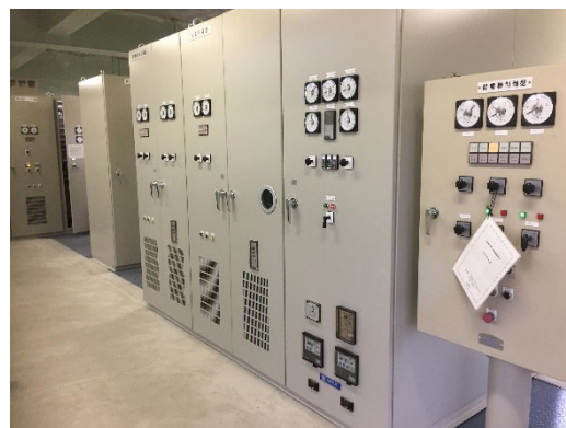
新しくなった電気設備
