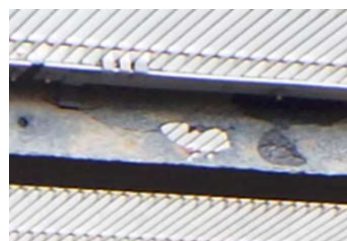
スクリーン架台の欠損、腐食
