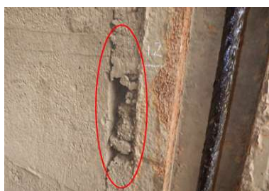
戸当り二次コンクリートの欠損
