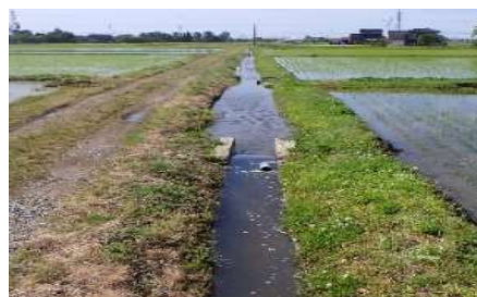
老朽化した用排兼用水路
